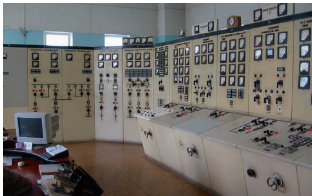
Главный щит управления станции
