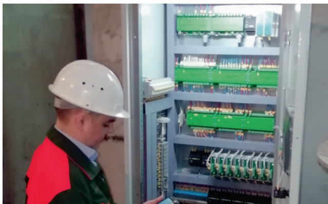
Щит управления в котельном отделении
