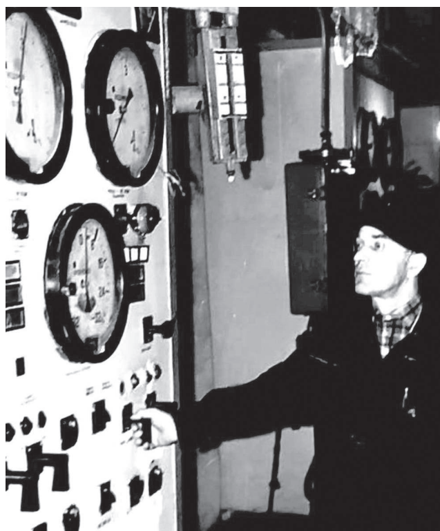
Установка автоматов и необходимых контрольно-измерительных приборов обеспечивала высокую культуру производства котельного отделения
