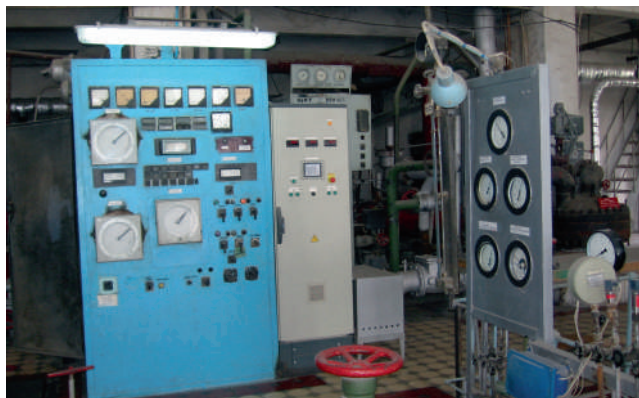
Щит управления турбогенератора № 3
